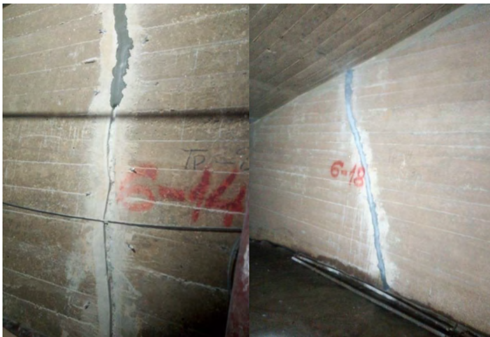
Рис. 5. Фрагмент восстанавливаемого участка холостого водосброса на этапе зачеканки штрабы и установки инъекционных пакеров
